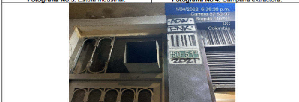
Fotografía No 5. Ducto de descarga.
